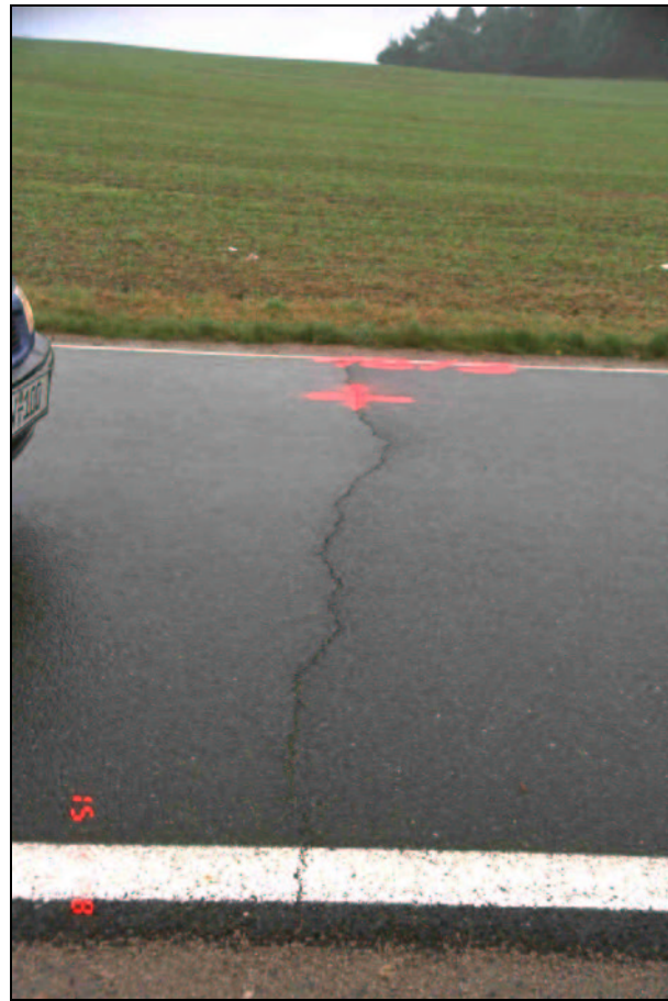
Bild 3: Streckenabschnitt mit einem typischen Querriss (S 279; Amtsgrenze Plauen - S 293) [4]
